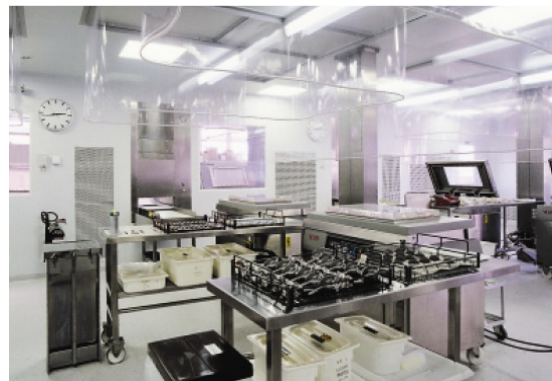
Bild: Genügt höchsten Ansprüchen: Von Cofely erbauter Reinraum bei Zimmer AG in Winterthur
